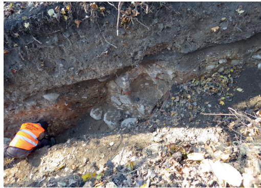
Fig. 7. Remains of the support wall of the bridge over the moat. Jn 7. Vallikraavi ületanud silla tugimüüri säilmed. Photo / Foto: Eero Heinloo
